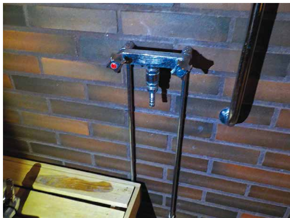
Bild 3.4. I gamla våtrum kan tätskiktet saknas helt och hållet. (Foto: P. Annila, Rakennusinsinööri Petri Annila)
