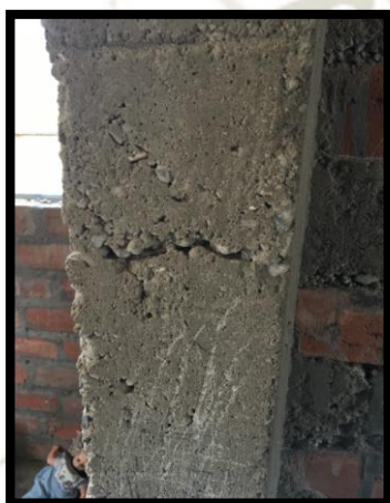
Figura N° 6.11: Presencia de cangrejera en columna Vivienda W-05 Anexo Tuctumpaya Fuente Elaboración Propia
