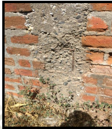
Figura N° 7.23: Columnas no cumple con el recubrimiento mínimo vivienda: W1 Piaca Fuente: Elaboración Propia
