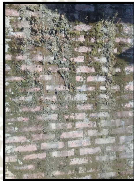
Figura N° 7.19: Muro de Albañilería con Alto deterioro superficial R-04 Anexo Pocsi Capital Fuente: Elaboración Propia
