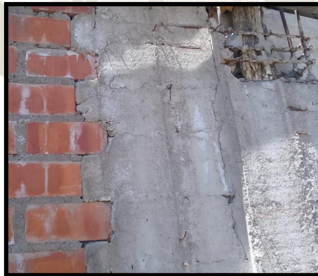
Figura N° 7.24: Columna vaciada con un Puntal de Madera Viviendas K-01 Pocsi Fuente Elaboración Propia
