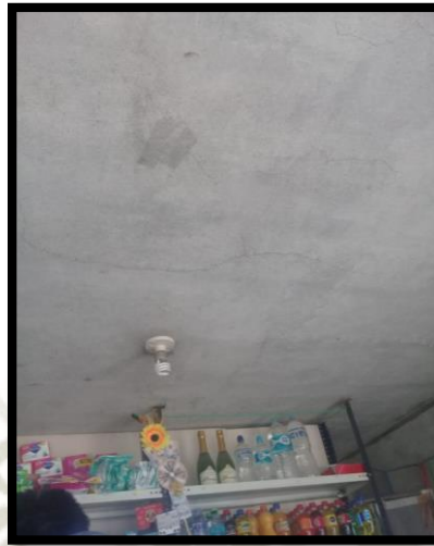
Figura N° 7.27: Presencia de Grietas en la Losa vivienda K-01 Anexo Pocsi Capital Fuente: Elaboración Propia
