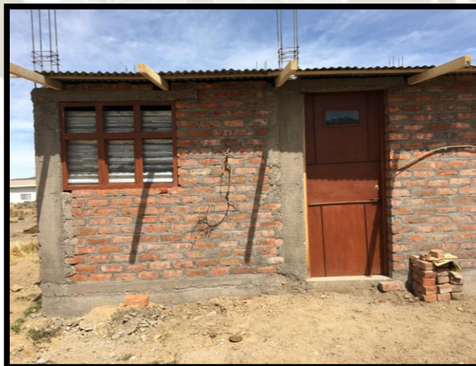
Figura N° 7.26: Losa Liviana (Calamina) en la vivienda en el Anexo Piaca T-15 Fuente: Elaboración Propia
