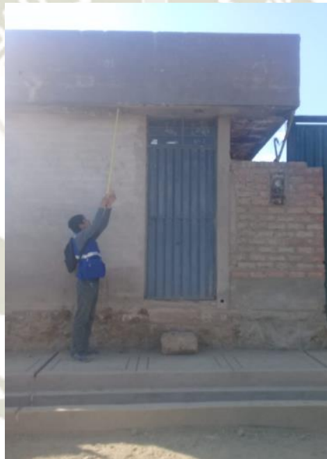
Figura N° 7.47: Voladizos sobre el retiro frontal mayores a 0.50 m Elaboración Propia
