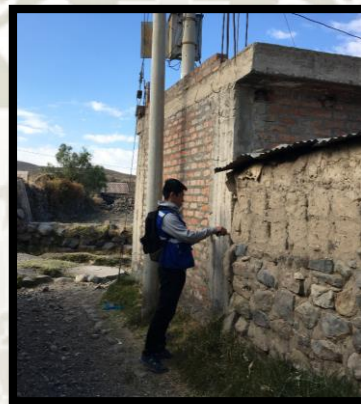
Figura N° 7.37: Vivienda con una unión endentada mayor a 50 mm Q-01 Anexo Piaca Fuente: Elaboración Propia
