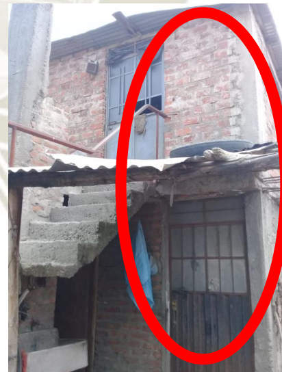
Figura N° 7.42: No existe Continuidad en vanos ni de las puertas en el primer y segundo nivel Fuente: Elaboración Propia
