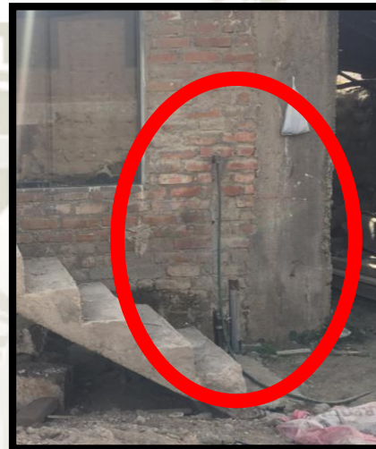
Figura N° 6.15: Tubería de agua mal ubicada Anexo Piaca M11 Fuente: Elaboración Propia
