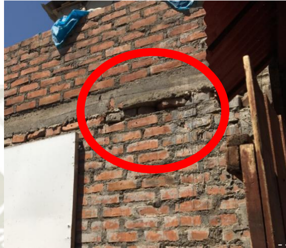
Figura N° 7.32: Baja calidad abrasiva del Mortero vivienda L-08 en el Anexo Pocsi Capital Elaboración Propia
