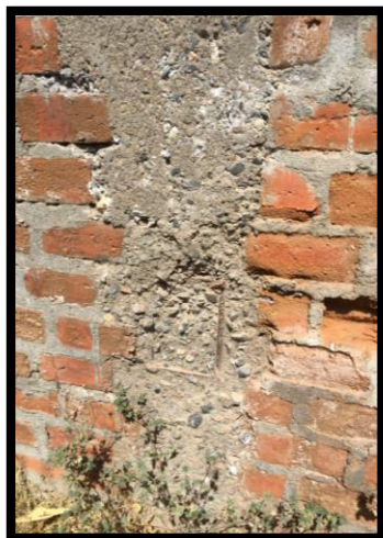
Figura N° 6.4: Aceros de refuerzo expuesto y oxidado Fuente: Elaboración Propia
