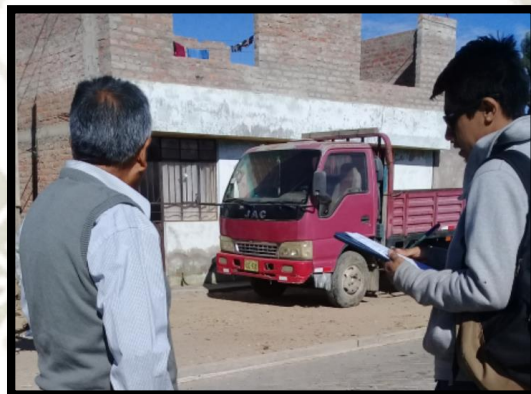
Figura N° 6.17: Tabiquería no arriostrada en el segundo nivel Fuente: Elaboración Propia
