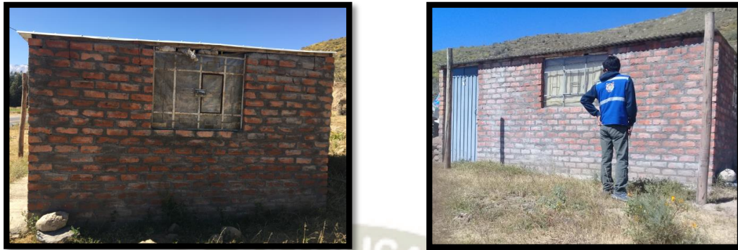
Figura N° 7.16: La vivienda W-01 de Pocsi Capital no cuenta con elementos de arriestre Elaboración Propia
