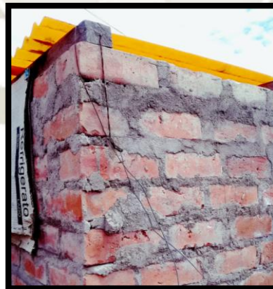
Figura N° 7.31: Características físicas en juntas en las viviendas de Pocsi Fuente: Elaboración Propia
