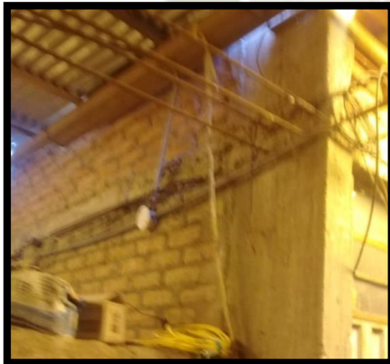
Figura N° 7.28: Acero de losa aligerada expuesto en el Anexo Pocsi Capital K-01 Fuente : Elaboración Propia
