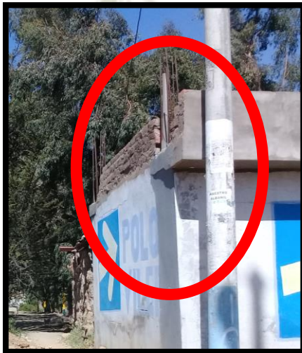
Figura N° 6.14: Tubería de desagüe mal ubicada Anexo Poci Capital D-06 Fuente: Elaboración Propia
