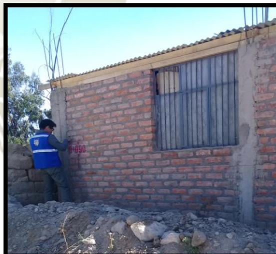
Figura N° 7.22: Aceros de columnas expuestos y en proceso de oxidación vivienda B5 Poci
