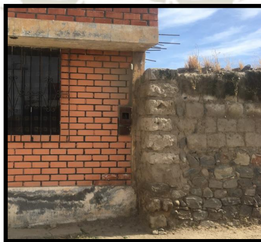
Figura N° 6.8: Vivienda Piaca no posee juntas sísmicas Fuente: Elaboración Propia
