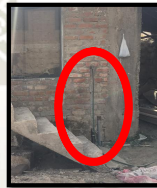
Figura N° 7.35: Tubería de agua mal ubicada Anexo Piaca M11 Fuente: Elaboración Propia
