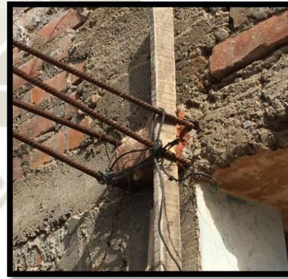
Figura N° 7.29: Acero de losa aligerada expuesto En el Anexo Huicchuña H-11 Fuente: Elaboración Propia
