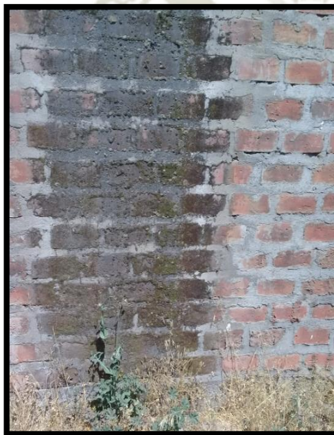
Figura N° 7.18: Muro de albañilería con Alto deterioro en la superficie W-02 Anexo Piaca Fuente: Elaboración Propia
