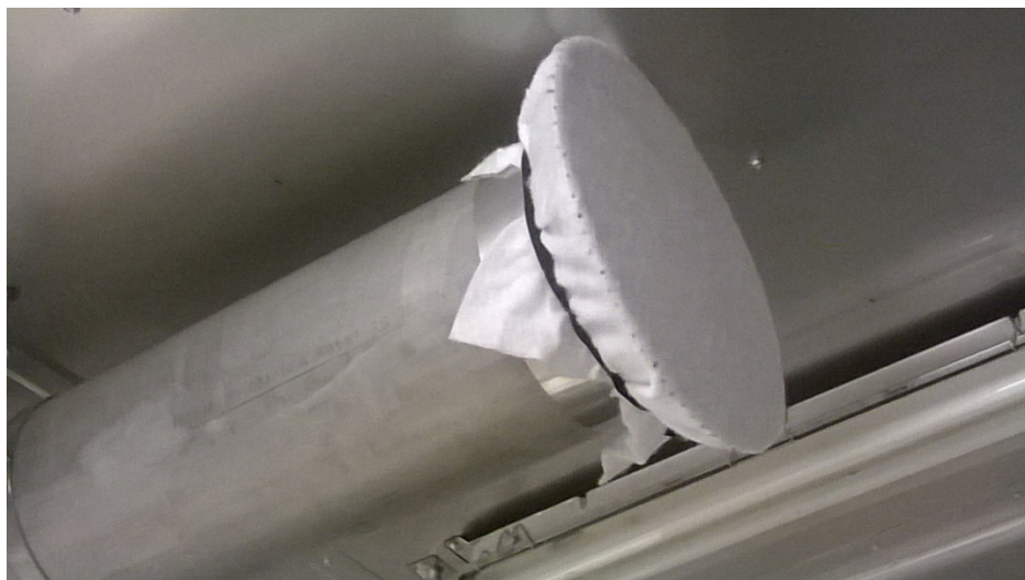
Kuva 4. Polypropyleenisuodatinkangas kiinnitettynä poistoilmaventtiiliin.
