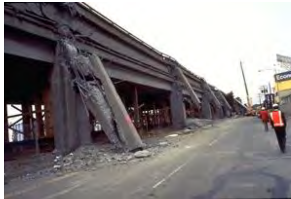
Figura 1. 1. Efecto del terremoto de Loma Prieta, colapso de cubierta superior y falla de columnas “Cypress Viaduct” (Foto: USGS Earthquake Hazard Program).
