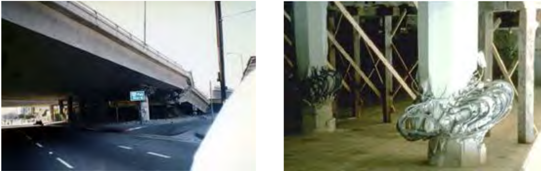
Figura 1. 2. Daños presentados durante el sismo de Northridge 1994 (Foto: U.S. Geological Survey).
