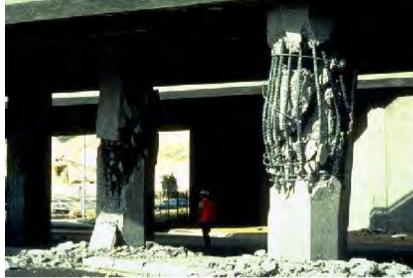
Figura 5. 14. Terremoto de 1971 en San Fernando, California. Estas columnas soportaban un puente, el daño que se presentó se debió a torsión (rotación horizontal) en las columnas. La torsión se traduce en fuerzas cortantes que actúan sobre el zuncho (refuerzo lateral en espiral). (Foto: NISEE 1971).
