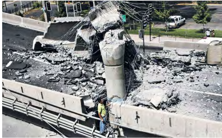
Figura 5. 3. Falla por deformación plástica en la columna de un puente carretero típico (Foto: Arquitectolegista).
