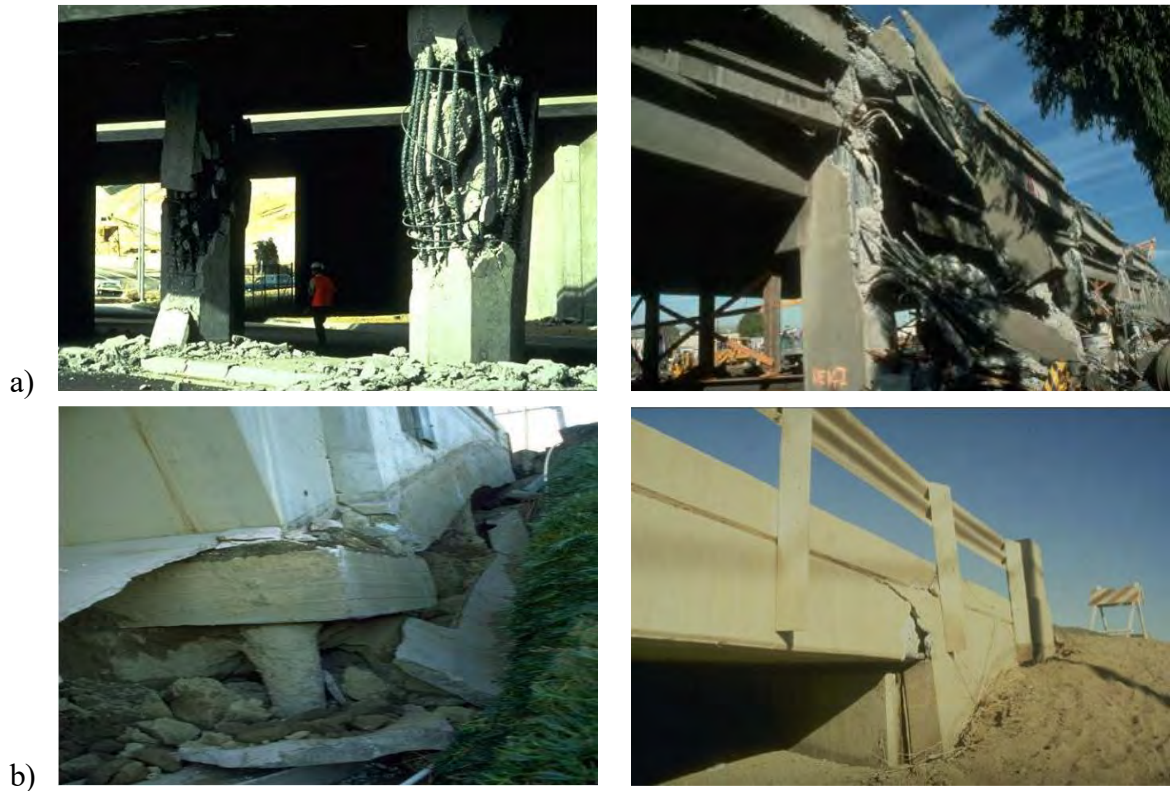
Figura 6. 1. Fallas comunes en puentes carreteros. a) Falla por cortante en una columna, sismo de San Fernando 1971, b) Falla por cortante en uniones viga – cabecero, c) Deslizamiento de un estribo, d) Asentamiento de un estribo.
