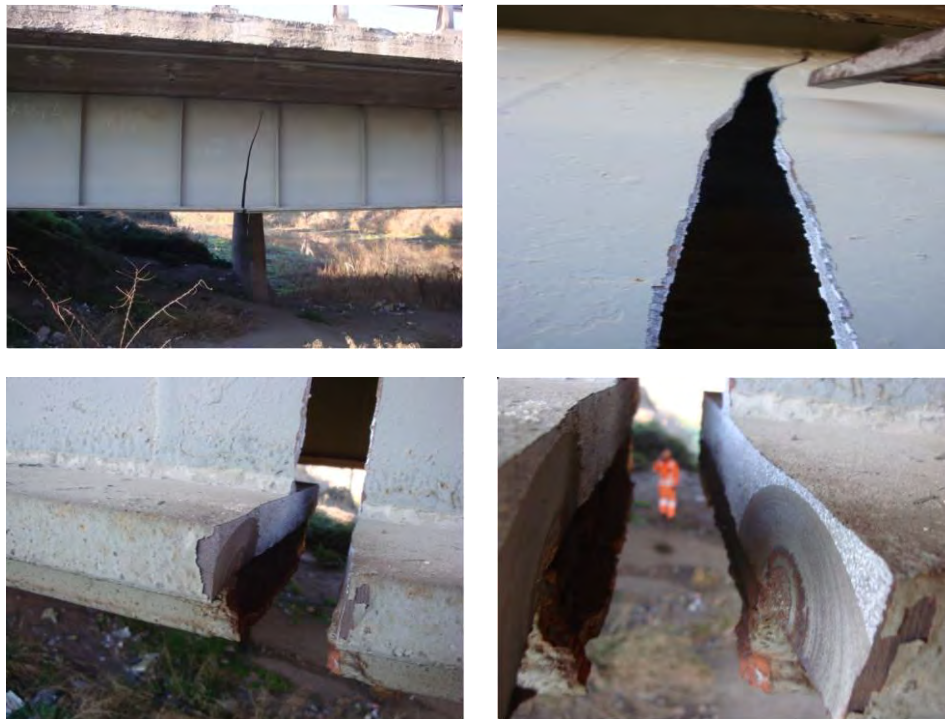
Figura 5. 11. Falla por fatiga en la viga de acero del puente Padahuel Norte en Chile (Fotos: JLS Ingeniería Estructural, 2011).
