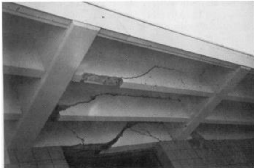
Figura 1-1. Daño en vigas de concreto.
