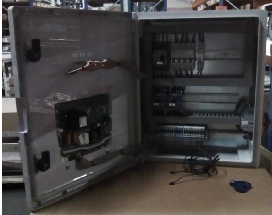
Figura 10: Interior do quadro elétrico
