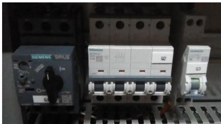
Figura 12: Aparelhagem no interior do quadro elétrico
