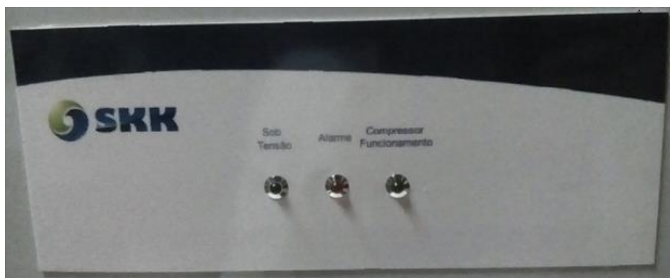
Figura 9: Painel na parte frontal do quadro elétrico
