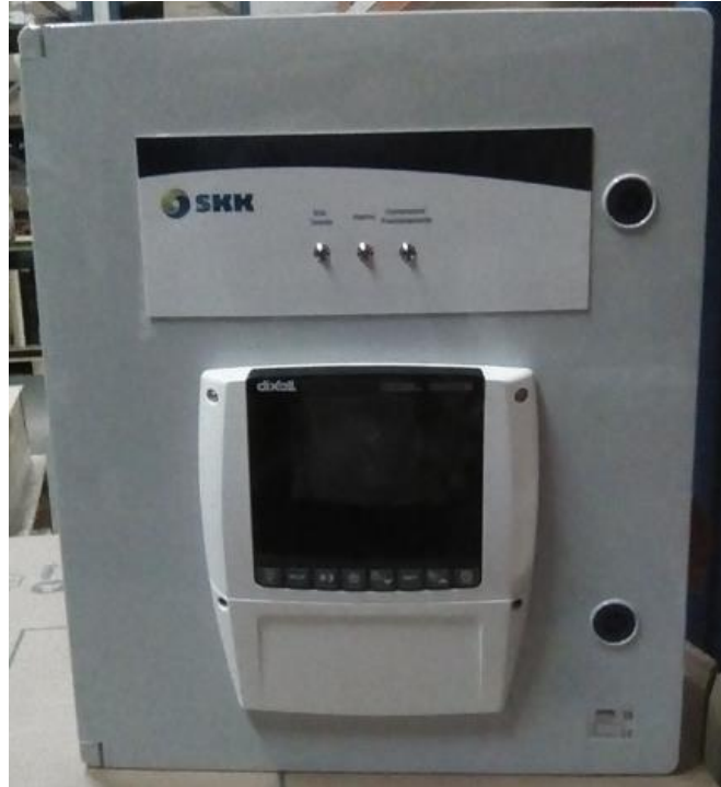
Figura 8: Parte frontal do quadro elétrico
