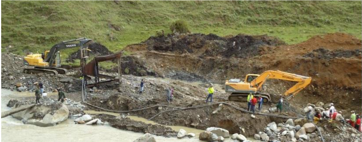
Foto 3: Evidencia de la explotación minera que se estaba realizando en la vereda Pavón-Urrao. Octubre 2012
