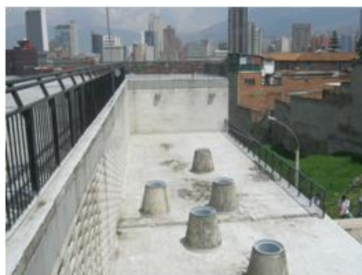
Muro que permite el acceso a la terraza desde la cancha. Institución educativa “La Caja de cristal” 2010.
