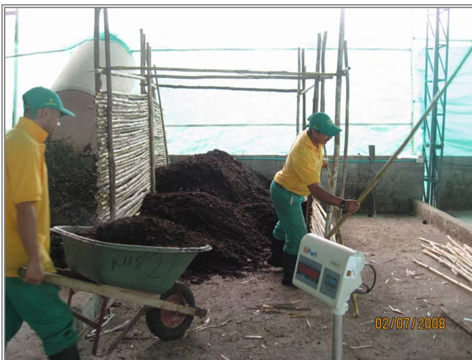
Foto 12. Planta de transformación de residuos sólidos orgánicos, San Antonio de Prado
