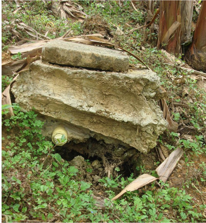
Foto 4. Detalle de la purga de los tanques.
