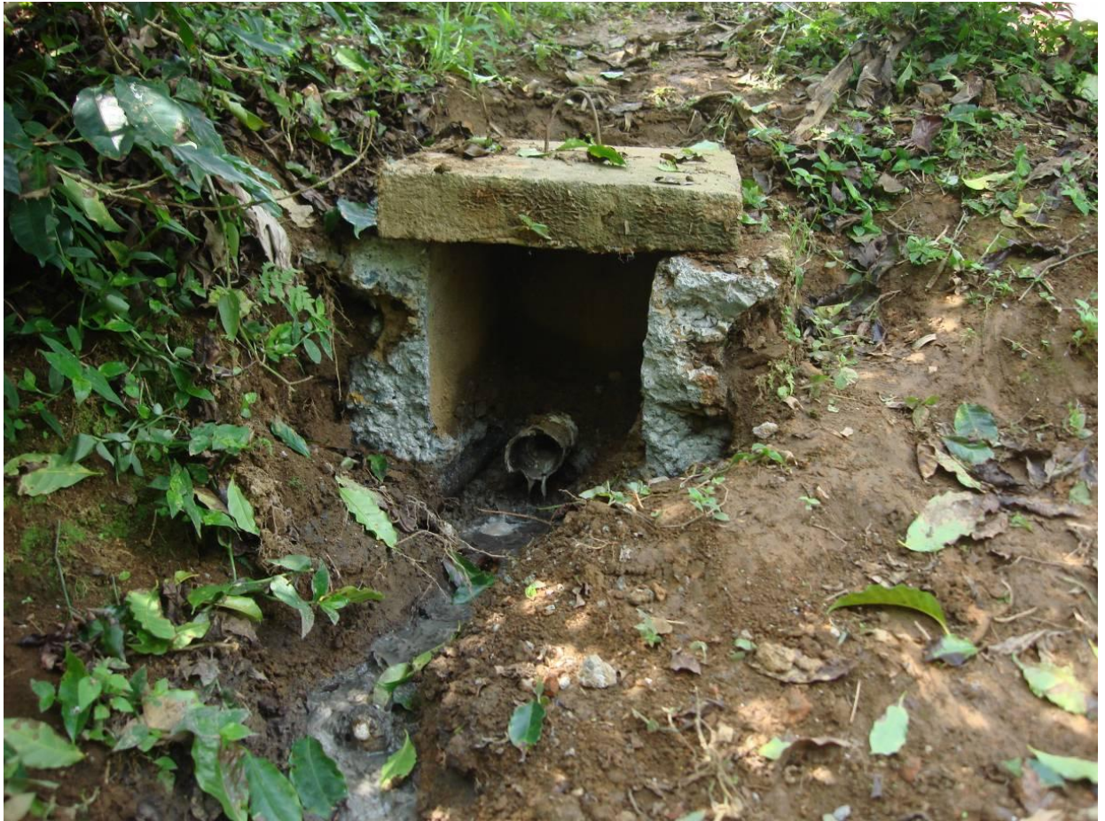
Foto 6. Manejo inadecuado de los lodos.
