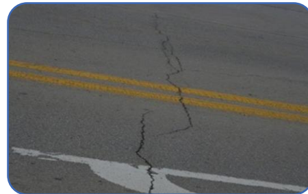
b) Transverse Crack
