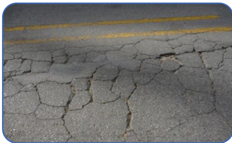
a) Fatigue Crack
