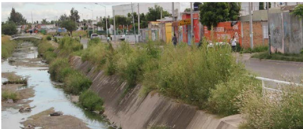
Fotografía 1: Imagen del estado actual de una sección del canal.
