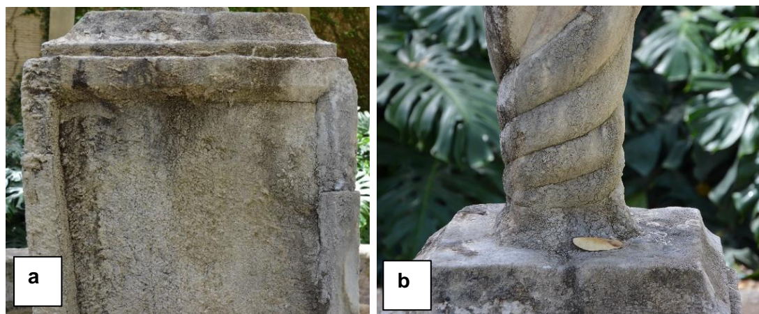
Figura 24. (a). Hinchamiento en la zona inferior del material, (b). Presencia de ampollas en la totalidad de la superficie. (Calvo, 2019).
