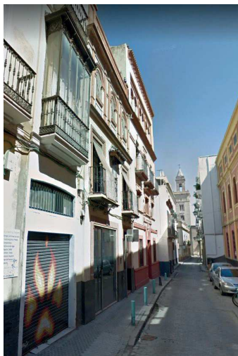
Vista del estado actual de la fachada del edificio G desde la calle Castellar./ Foto Google 10/07/2019.
