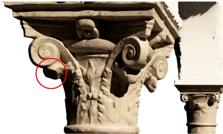
Figura 46. Defecto en el capitel de columna 5 (ID en el proyecto HBIM: Capitel_5 ). Fuente: (Antón et al. , 2018).
