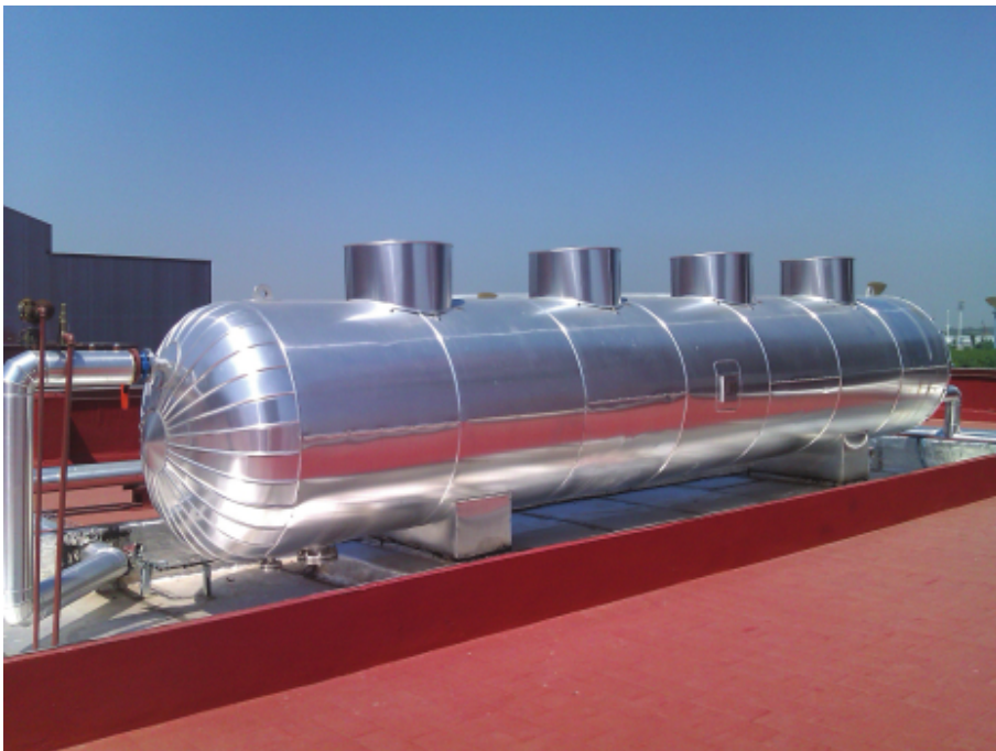
Figura 3.1 Acumulador de Energía de la ETSI de la Universidad de Sevilla.
