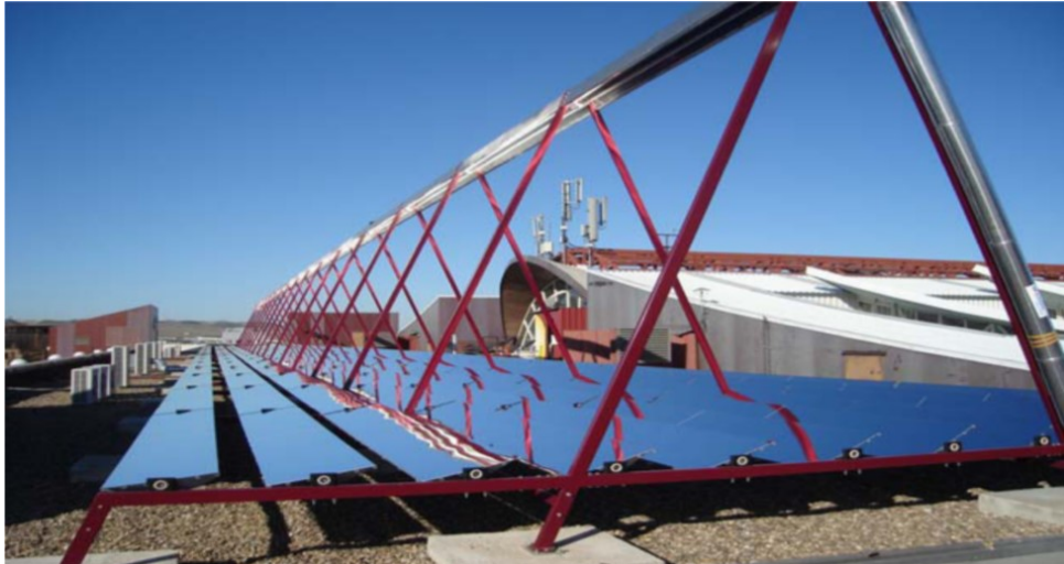
Figura 2.6 Estructura y captadores solares de Fresnel de ETSI. Nótese que no hay ninguna estructura más alta que pueda dar sombra a los espejos.
