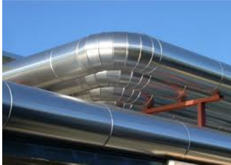
Figura 2.11 Imagen de distintas tuberías.
