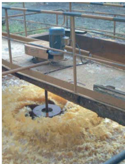
3.12. ábra: A bányavíz levegőztetése
