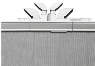
3.32 Dispositivo impiantistico in copertura, Centro Commerciale Roma Est a Ponte di Nona, Roma
