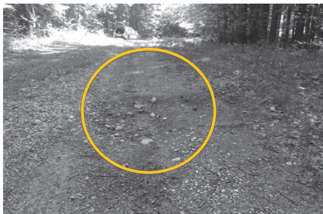
Slika 2. Udarne rupe na dijelu šumske ceste
