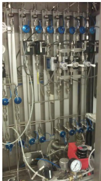
Armoire de débitmètrie
