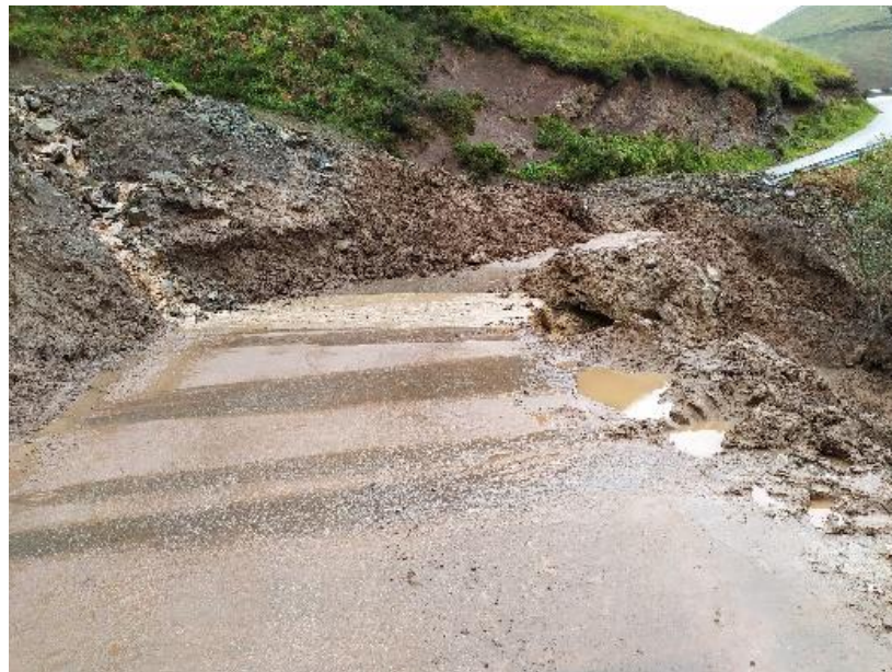
Ilustración 4.26: Movimiento 5 Rotura de la carretera.
