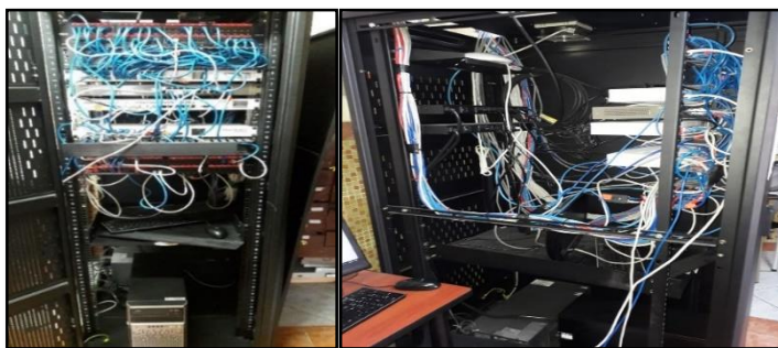
Figura 3.2. Rack mantenimiento técnico e informáticos de 36 U.
