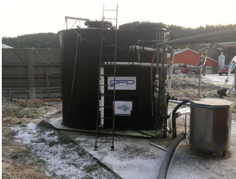
Figur 6. Biogass reaktorhus med gjødsellager i bakkant og pumpekum for retur i rustfritt stål til høyre.
