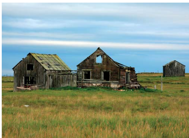
Et eksempel på bygninger i sterkt forfall og areal ute av drift, Vadsø. Foto: O. Puschmann, Skog og landskap.
