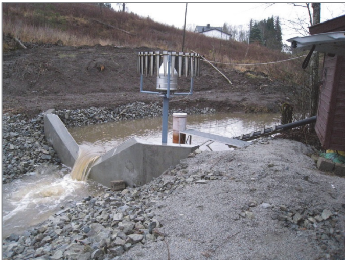
Figur 2. Det nye V-overløpet som ble anlagt i Kolstadbekken i 2012. Nedbørmåleren ses midt i bildet, målehytta til høyre. Foto: Bioforsk.
