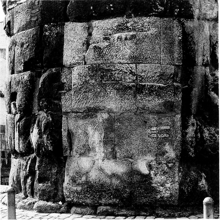
63: Musterfeld MF2 zur Reinigung nach der Applikation einer kombinierten Reinigungsvariante auf der Ostseite des Turmes der porta praetoria. Die feucht erscheinende Fleckigkeit beruht auf der Einlagerung hygroskopischer Salze in der korrodierten Kalksteinoberfläche (2002).
