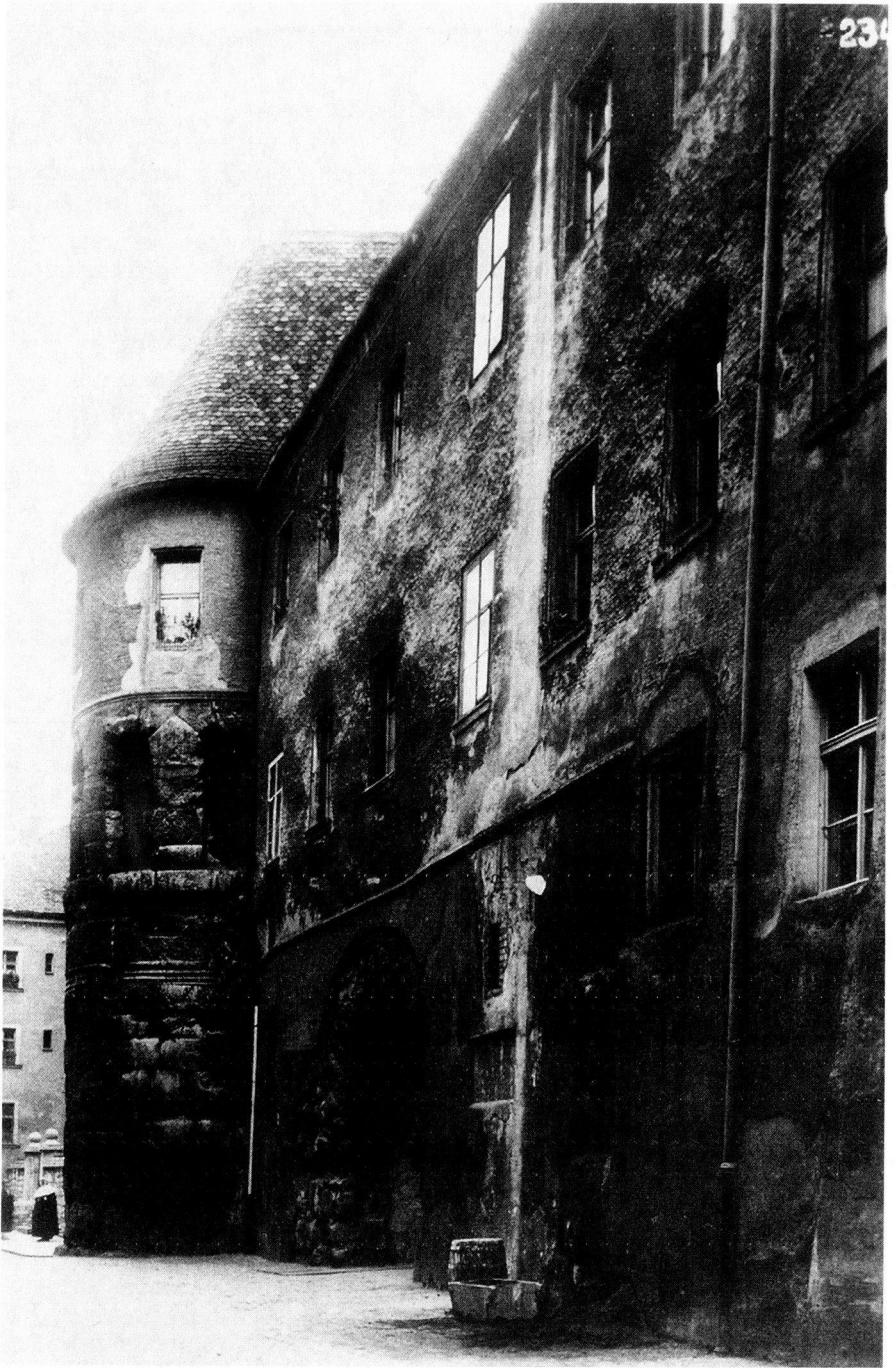
20: SW-Fotografie um 1924/1925: Die Putzfassade des Bischofshofes befindet sich in einem katastrophalen Zustand (Stadtbildstelle Regensburg).
