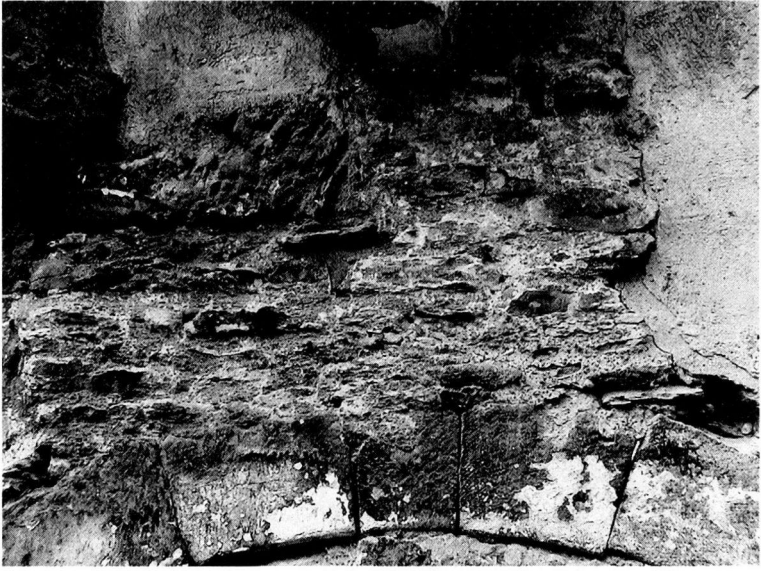
53: Segmentbogen des kleinen Portals, das in den Ostturm führt (Eingang Sudhaus); oberhalb des Sturzes ist das Mauerwerk mit Grünsandstein ausgemauert, in der Umgebung sieht man die aufgerauten Putzflächen von 1958 auf dem Putz von 1910.
