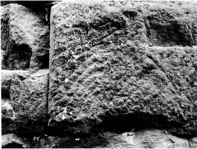
47: Flächendeckender schwarzer Belag auf sämtlichen Oberflächen der porta praetoria; es sind keine Differenzierungen möglich, die Ansprache der Werkstoffe – Mörtel, Kalksteinfazies, andere – ist sehr erschwert. Aufnahme vor der Reinigung (Detail der Nordseite des Ostturms, Augenhöhe; 2001)
