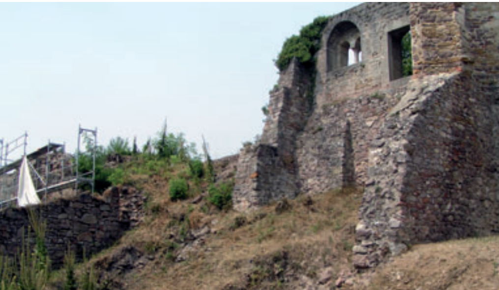
Abb. 5: Blick auf die zerstörte Nordwand des Palas zu Beginn der Sanierung 2005
