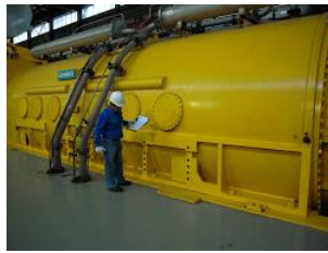
Gambar 15. Memeriksa dan Menguji Performance Generator
