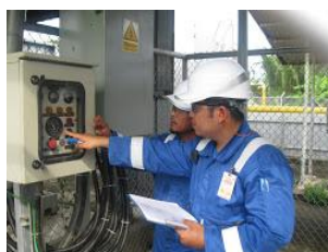
Gambar 22. Memeriksa Instalasi Kontrol Panel
