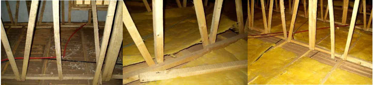
Figura 5: cielorraso desde el ático. Se puede observar que la aislación es incontinua.
