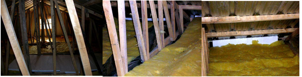
Figura 8: fotos mostrando la colocación de la lámina de polietileno y el poliestireno expandido en los bordes y entre cabreadas cuando fuera necesario.
