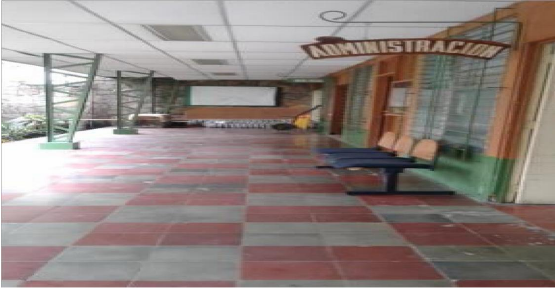
Imagen 1: No se visualiza señalización, y solo se encuentra un extintor donde hay 5 Oficina.
