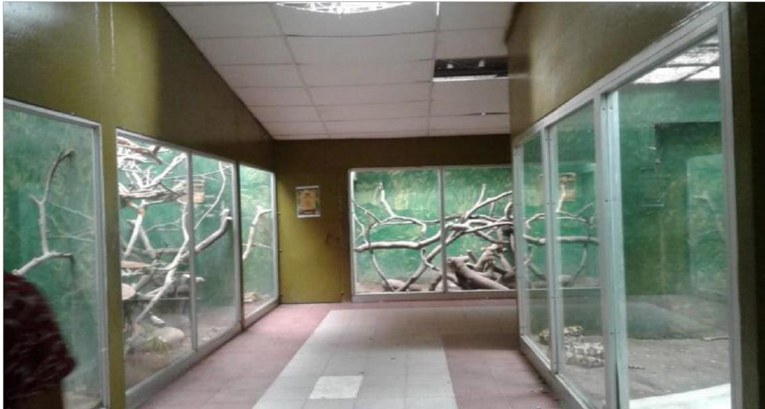
Imagen 11: Infraestructura en mal estado y no se observa señalización de prevención de riesgos.
