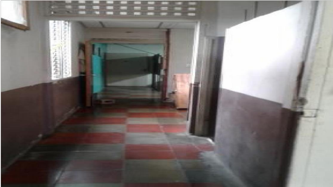
Imagen 5: No se observa señalización de prevención de riesgos, ni ruta de evacuación o algún extintor.
