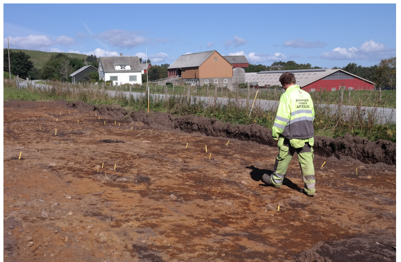
FORSIKTIG: Prosjektleder Volker Demuth og hans kolleger graver ut området hvor det skal lages sykkelsti. FOTO: KIRSTI KASTRUP SØMME
