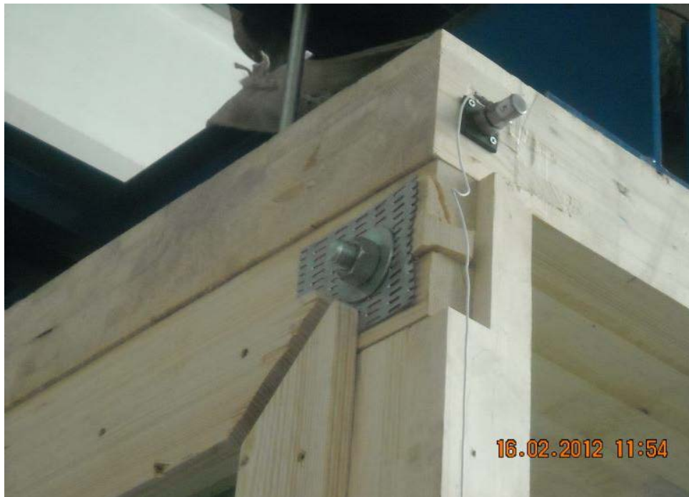
Слика 4.4.65: оштећење на вези штапова дрвеног рама, за други случај (један завртањ и метални конектер) – виде се трајна деформација металног конектера и пукотина на хоризонталном дрвеном штапу 80
