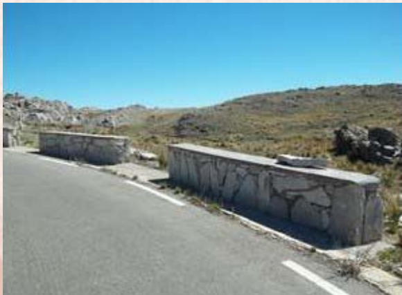
Barandilla protectora en ruta
