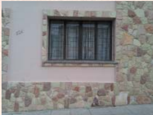
Aplicación en fachada de vivienda de la localidad de Comodoro Rivadavia, Chubut
