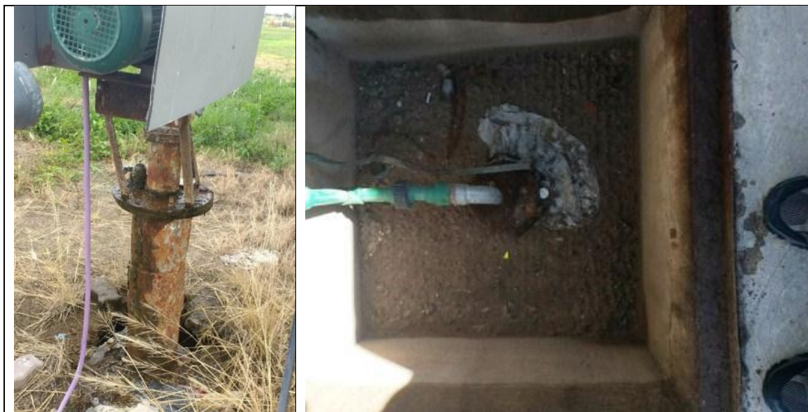
Figura 8.12. Perforaciones en malas condiciones, deterioradas por características de las aguas.
