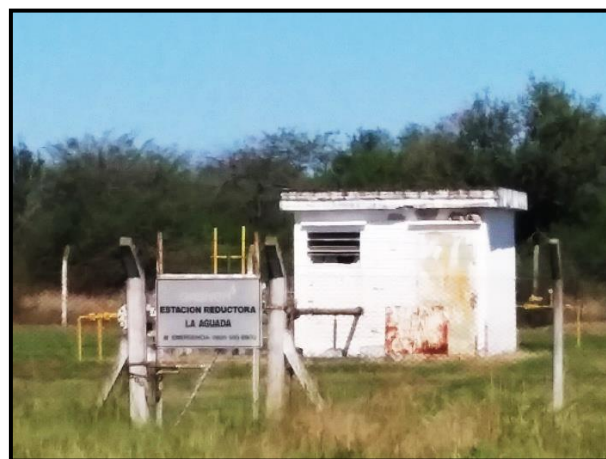
Figura 10.6. Estación reductora La Aguada.
