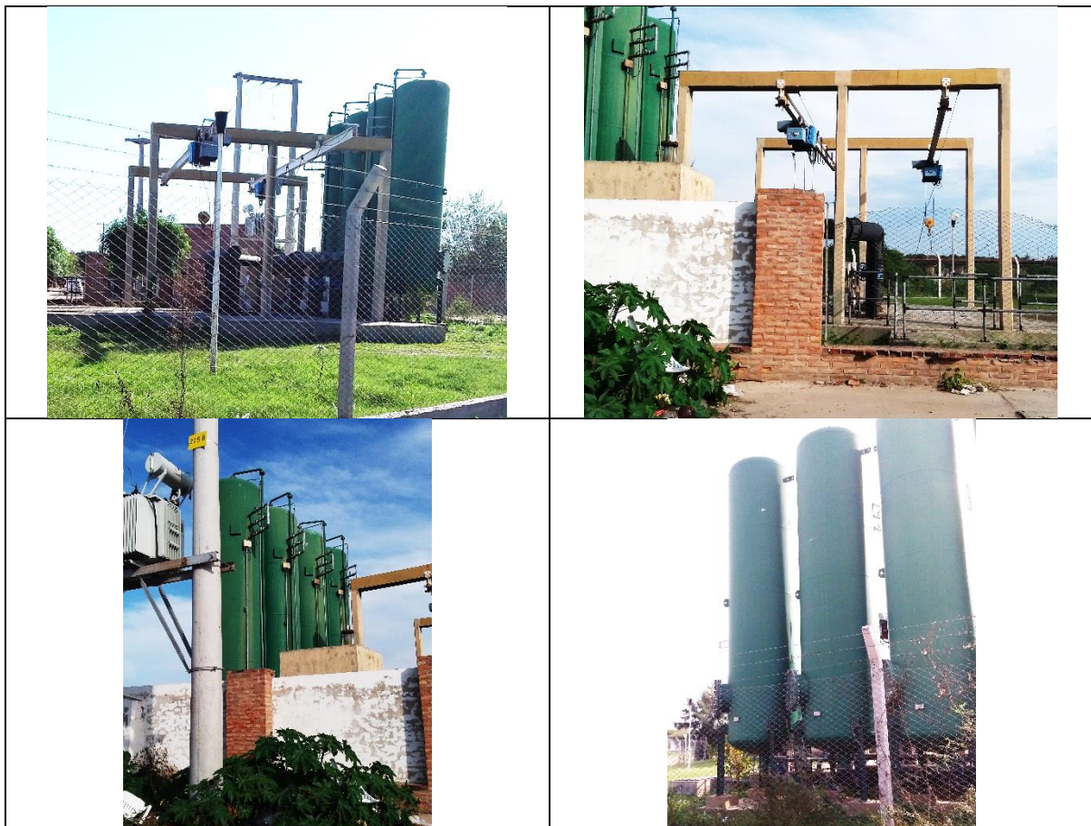
Figura 10.11. Imágenes de la planta de tratamiento cloacal.
