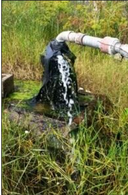
Figura 8.13. Perforación deteriorada producto de la surgencia.
