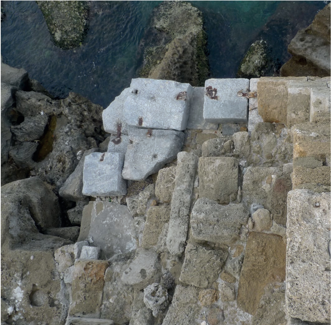
Fig. 18: Rodi, torre di Naillac. Veduta dall'alto dell'angolo dissestato in un angolo della torre, esposto alle onde marine.
