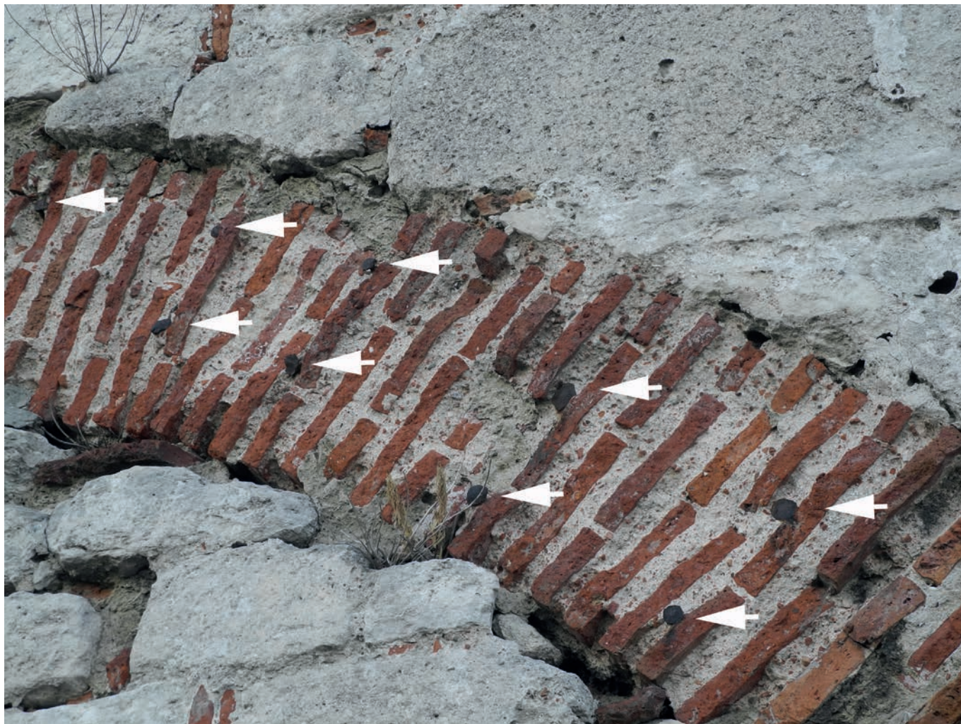
Fig. 17: Istanbul, Yedi Kule. Chiodature di ferro nei giunti di un arco laterizio (fotografia C. M. Amici).
