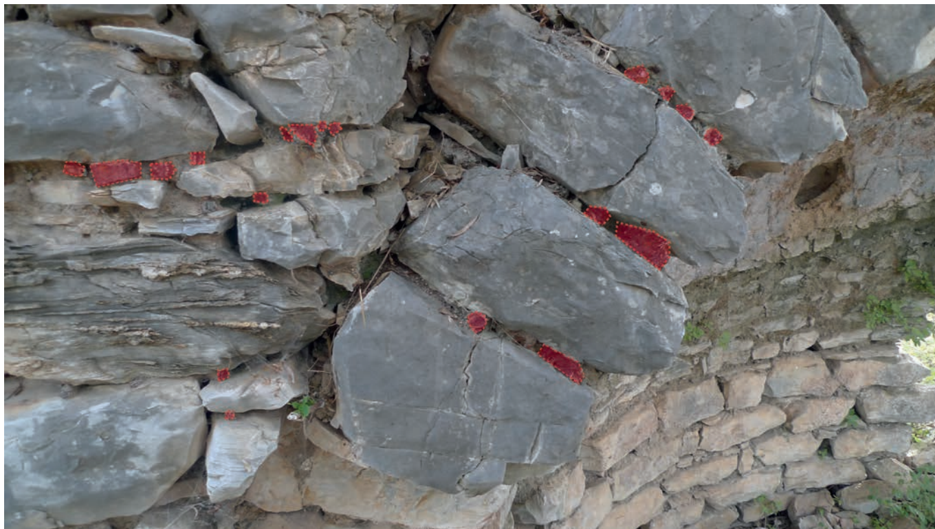
Fig. 9: Particolare dell'arco frontale della nicchia e della muratura, con evidenziazione degli elementi metallici tra le pietre.
