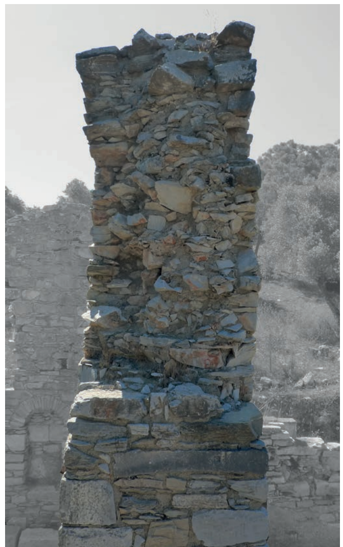
Fig. 12: Sezione di un muro in conglomerato del Caesareum nell’agorà. Il nucleo è composto da materiale mediamente di pezzatura piccola e sporadici blocchi più grandi disposti “a sacco”. Il paramento è composto da pietre di media pezzatura.
