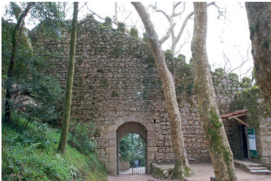
Figura 14. Reconstrucción histórica (Etapa II) del arco de la puerta del lienzo oriental (interior).
