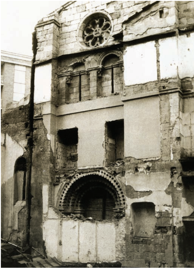
Fig. 17. Demolición de la casa adosada a la fachada oeste de la iglesia (1976, Colección Ángel L. Esteban Ramírez)
