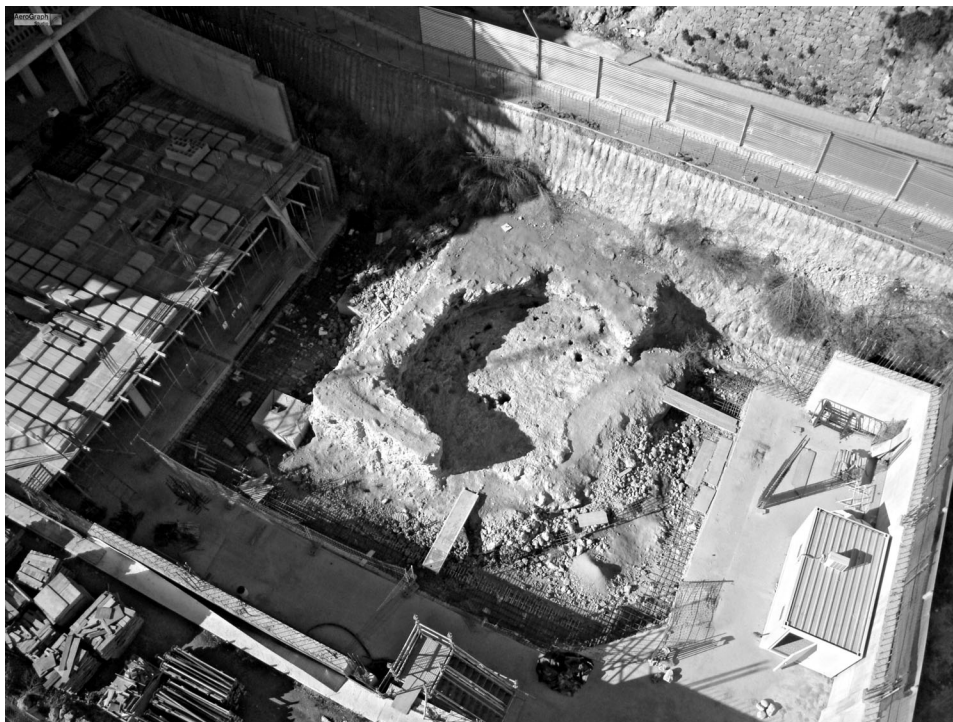
Lám. IV. Vista aérea del enterramiento de Camino del Molino una vez finalizada la excavación.
