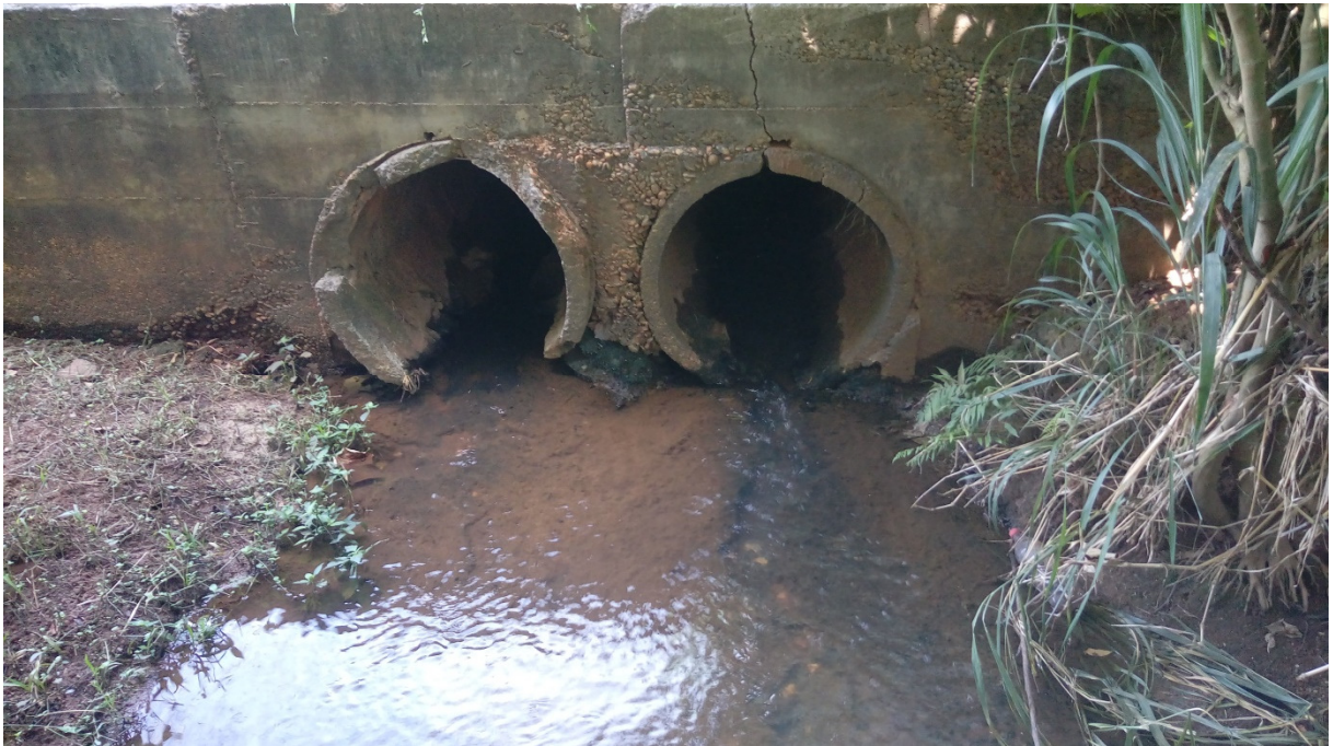
Figura 8. Lançamento de drenagem pluvial ao lado do IBAMA.
