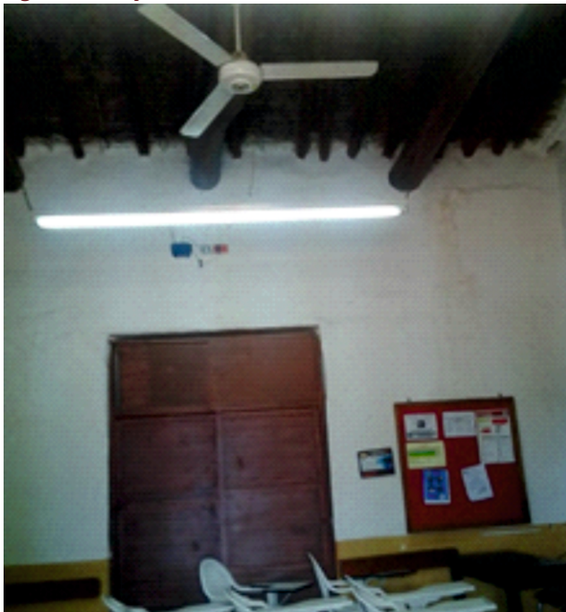
Figura 1. Desperdicio eléctrico salón M3.
