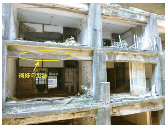
写真10 はく落したコンクリートの補修跡
