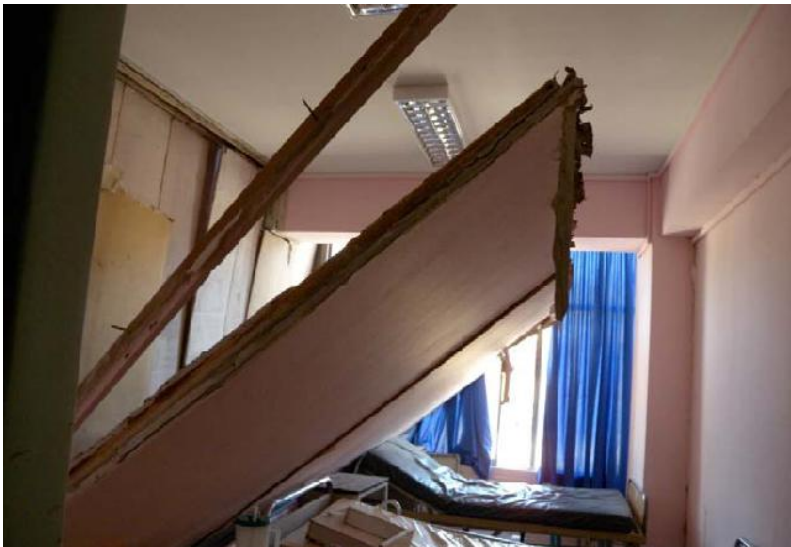
Figura 2.6 - Ribaltamento di un muro di ripartizione presso il Santiago General Hospital in Cile (Fierro et al., 2011).
