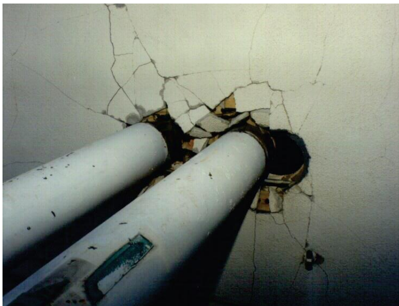
Figura 2.22 - Danni a tubazioni a causa di un attraversamento in un solaio (FEMA, 2012).
