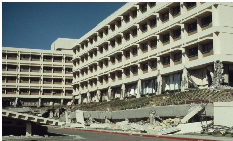
Figura 2.2 - Collasso del primo livello dell'Olive View Hospital (FEMA, 2007).
