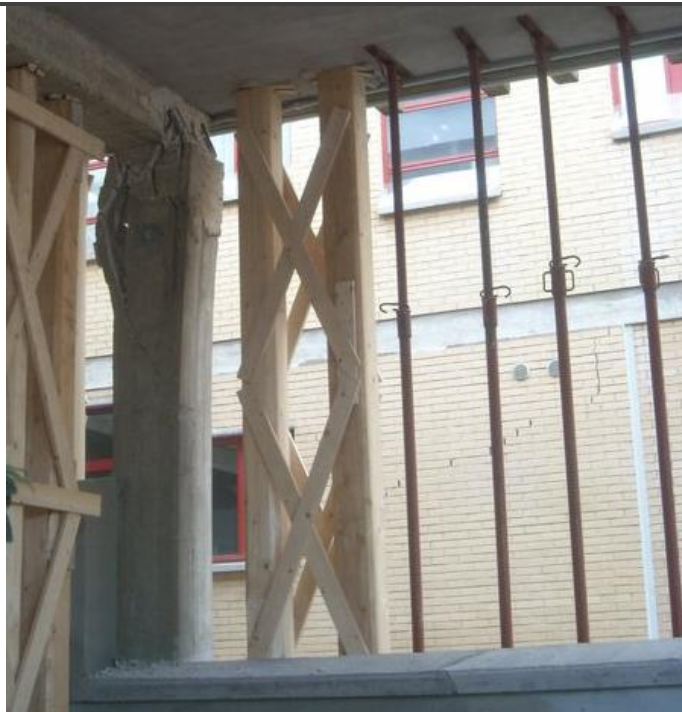
Figura 2.32 - Danneggiamento colonna al piano terra.
