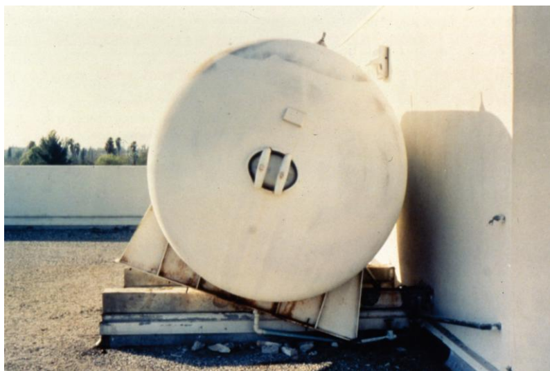
Figura 2.20 - Slittamento del serbatoio dal cordolo di supporto (FEMA, 2012).
