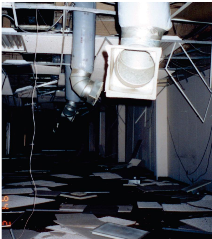
Figura 2.23 - Rottura dei condotti dell'areazione (FEMA, 2012).
