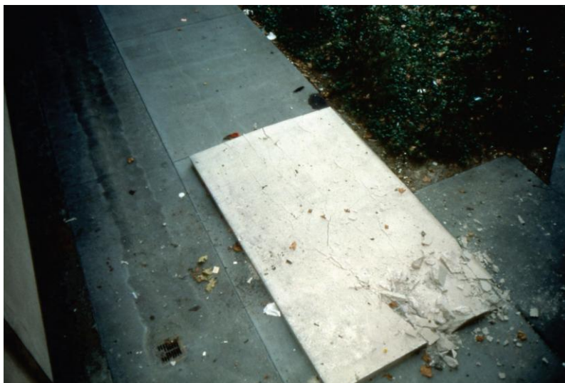
Figura 2.8 - Danneggiamento degli ancoraggi di un pannello prefabbricato con conseguente caduta a terra (FEMA, 2012).
