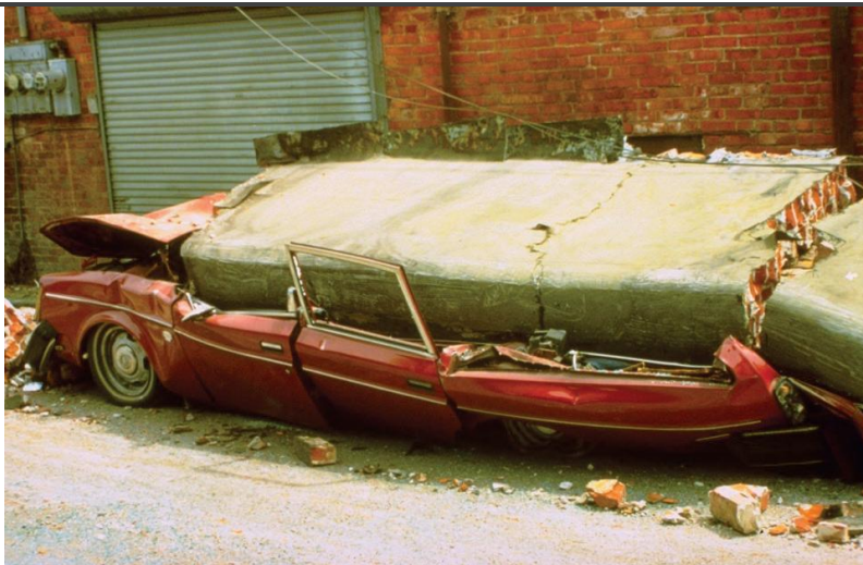
Figura 2.10 - Ribaltamento di un parapetto con conseguente danneggiamento di auto in sosta (FEMA, 2012).
