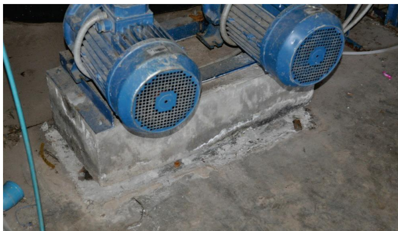
Figura 2.16 - Scivolamento di pompa e blocco in cemento (FEMA, 2012).
