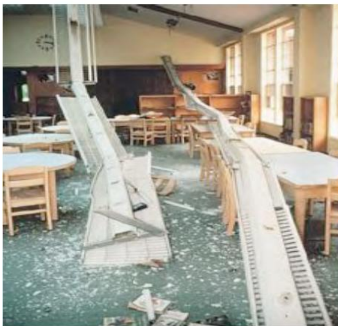
Figura 2.5 - Danneggiamento del sistema di illuminazione (Linee Guida Reluis, 2009).
