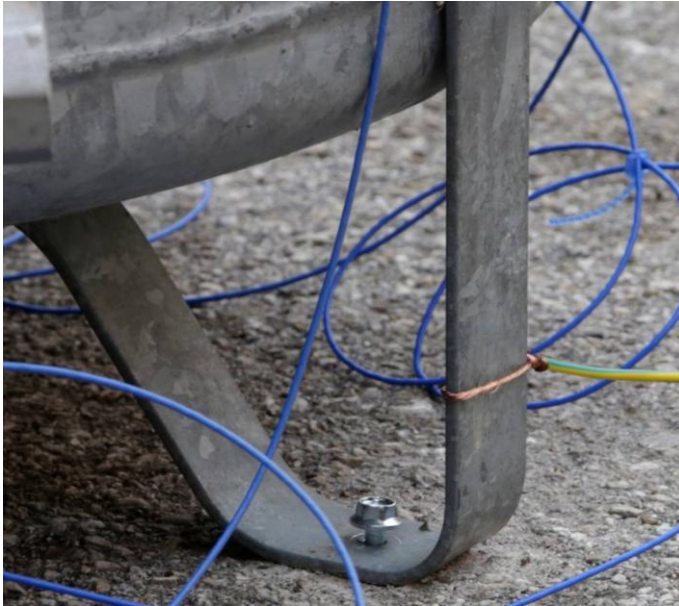
Figura 5.43 - Serbatoio non ancorato al suolo (danneggiato).
