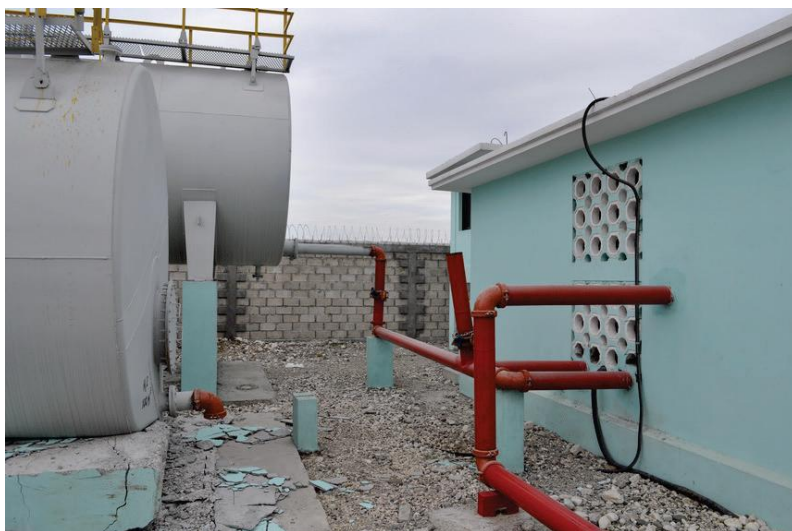
Figura 2.25 - Danneggiamento dei supporti di serbatoi dell'impianto antincendio e conseguente rottura delle tubazioni (FEMA, 2012).
