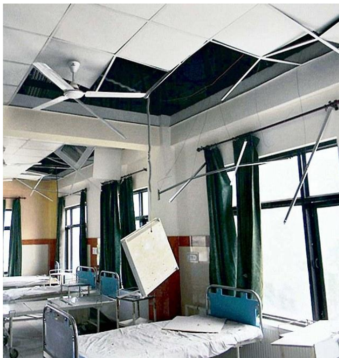
Figura 2.4 - Danni alla controsoffittatura nel reparto di degenza (FEMA, 2012).
