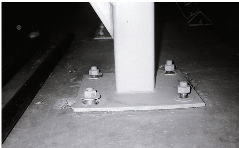
Figura 2.30 - Danneggiamento alle connessioni di serbatoi in copertura (FEMA, 2007).
