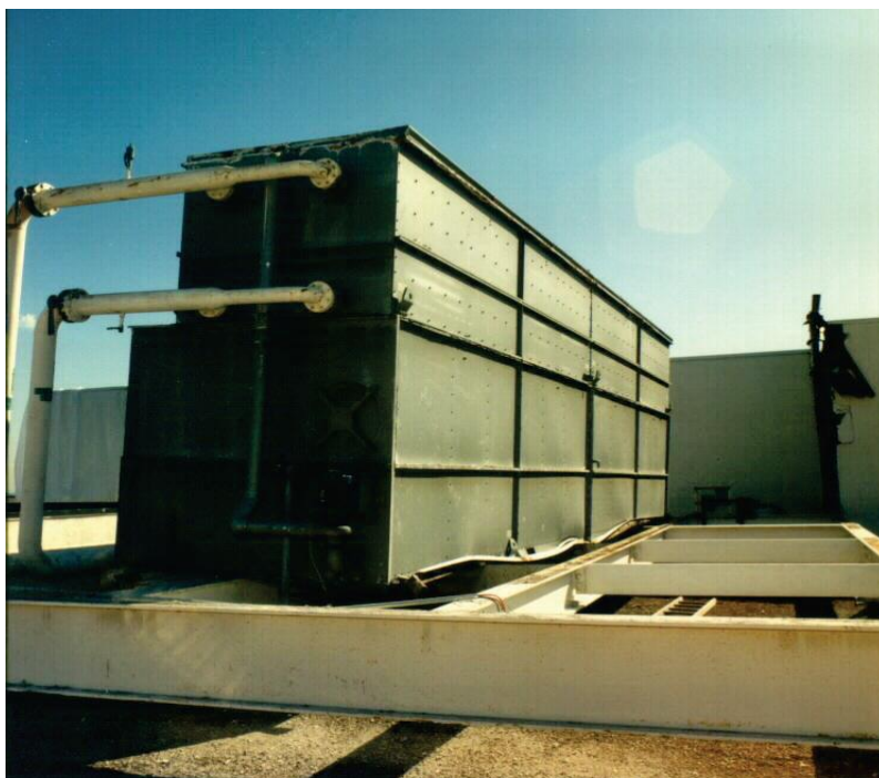
Figura 2.17 - Impianto HVAC posto al livello della copertura che ha manifestato il danneggiamento delle connessioni (FEMA, 2012).
