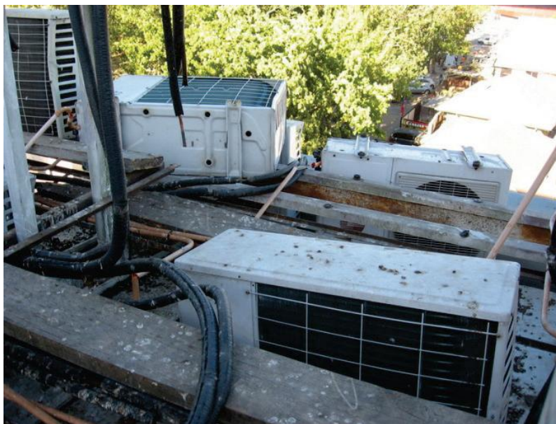
Figura 2.18 - Ribaltamento di unità di condizionamento (FEMA, 2012).
