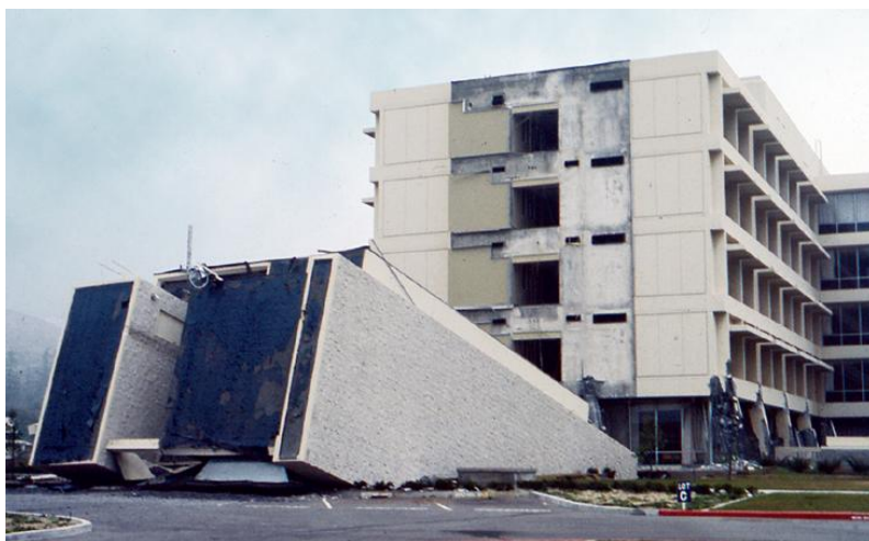
Figura 2.29 - Ribaltamento della torre scala (FEMA, 2007).
