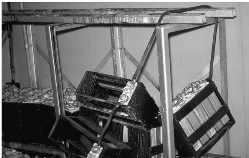
Figura 2.14 - Batterie non opportunamente ancorate hanno subito un danneggiamento a seguito di un evento sismico (Miranda & Taghavi, 2003).
