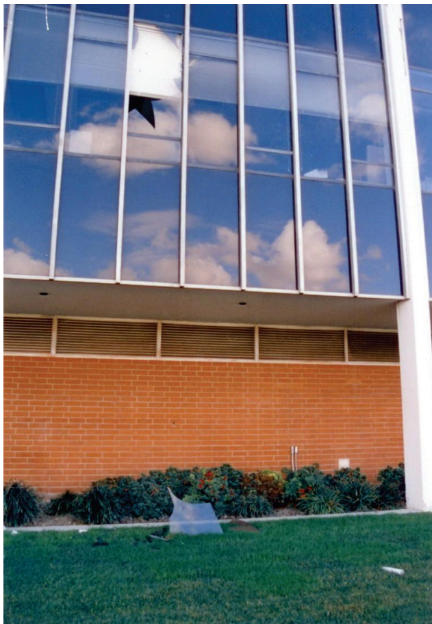
Figura 2.9 - Danneggiamento superficie vetrata (FEMA, 2012).
