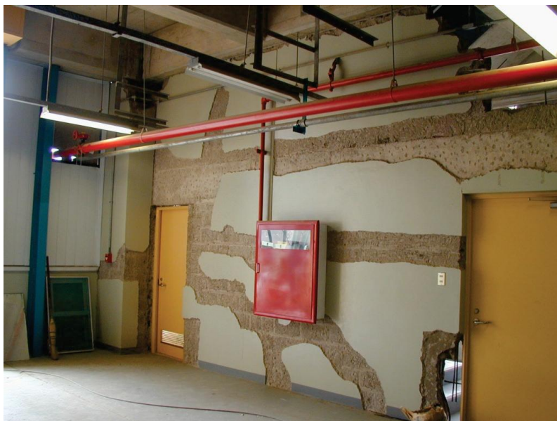
Figura 2.7 - Danno ad una parete utilizzata per il supporto di tubature per l'antincendio (FEMA, 2012).
