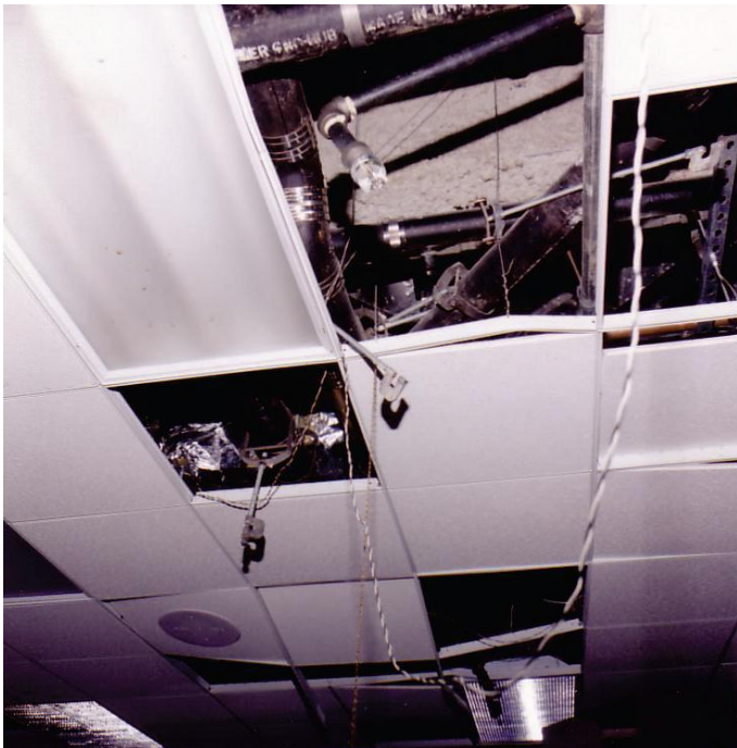
Figura 2.24 - Danneggiamento impianto sprinkler all'interno della controsoffittatura (FEMA, 2012).
