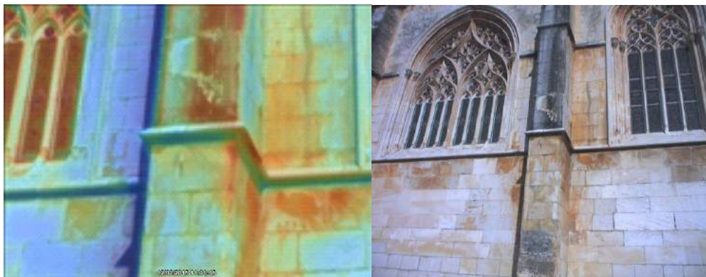
Figura 7 - Termografia das crostas negras e respetiva foto da localização
