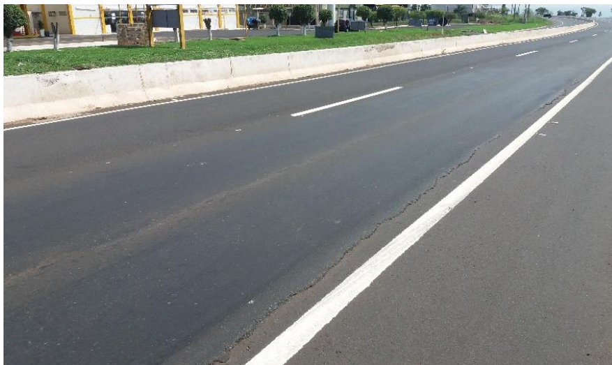
Figura 7: Afundamento do trilho de roda.
