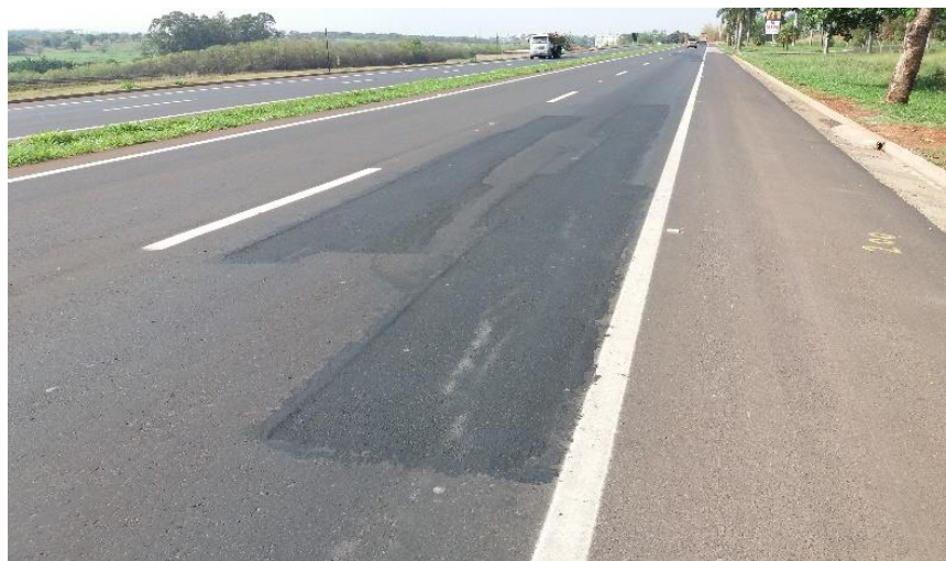
Figura 4: Remendo encontrado no pavimento.
