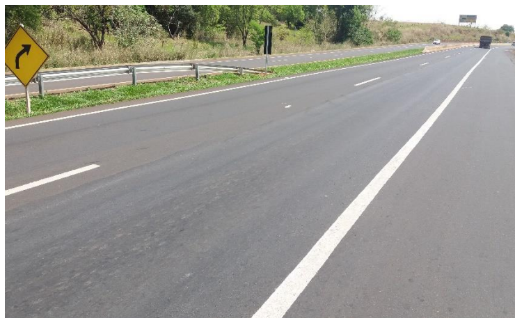
Figura 8: Afundamento encontrado em trecho de aclive.
