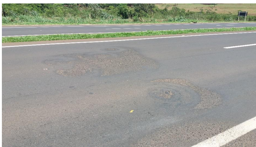
Figura 9: Desgaste superficial encontrado na rodovia
