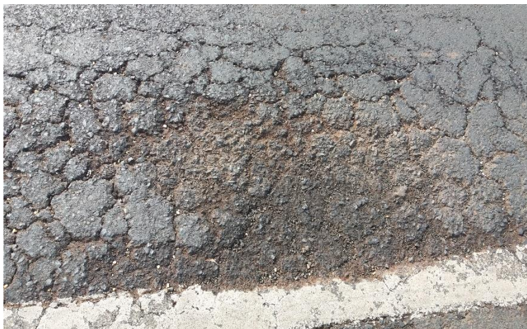
Figura 6: Trinca couro de jacaré com erosão.
