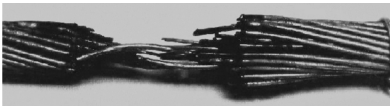
Рис. 2. Повреждение провода в результате субколебаний
