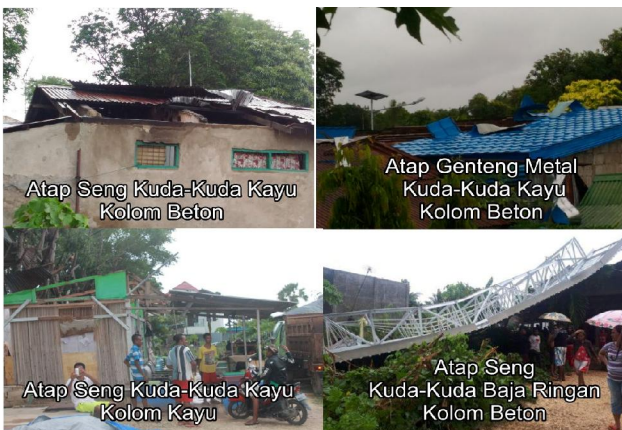
Gambar 7. Kondisi bangunan terkena angin puting beliung di lereng
