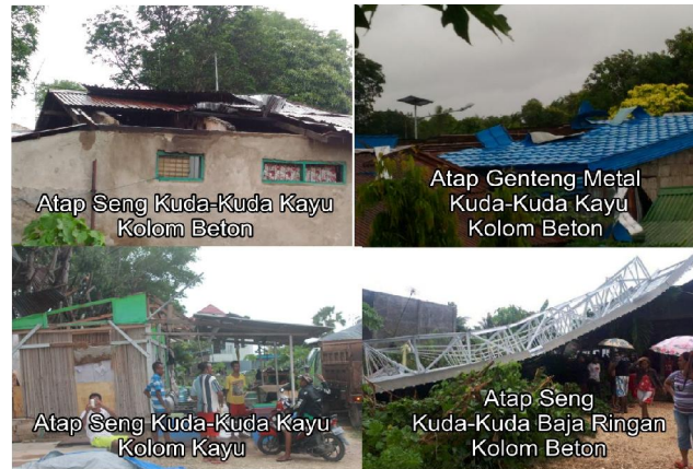
Gambar 6. Foto kerentanan terhadap atap bangunan
