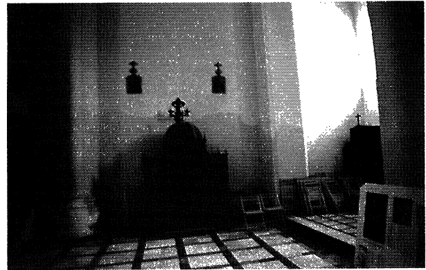
Fig. 2.- Nivel de humedad debido a la ascensión capilar. Fig. 2.- Raising Damp Level.
