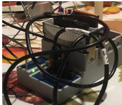
Figura 12-3. Instalación de termopares y caudalímetro a la DAC
