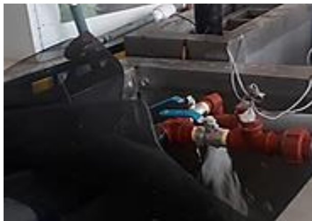
Figura 8-3. Termopares a la entrada y salida del serpentín
