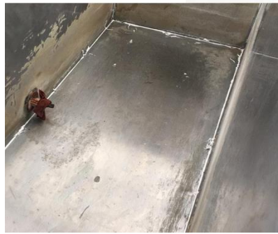
Figura 5-4. Deterioro en sellos y empaques
