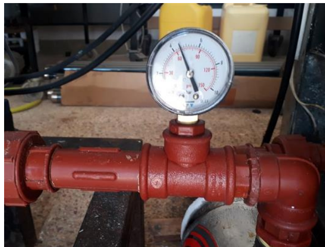
Figura 10-3. Manómetro instalado a la salida de bomba
