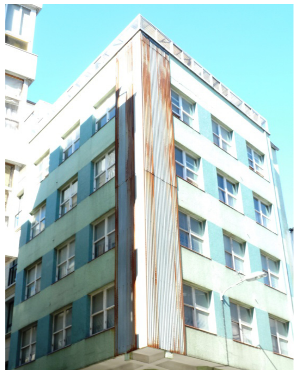
Edificio degradado con menos de cincuenta años.
