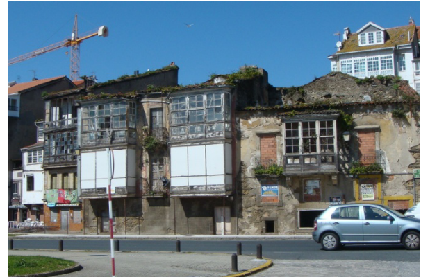
Estado de abandono y ruina de edificios en un barrio tradicional de Ferrol
