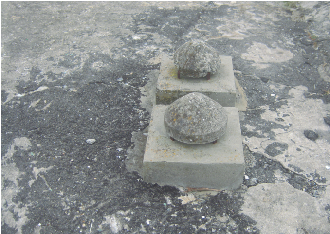
Figura 19. Respiraderos de hormigón
