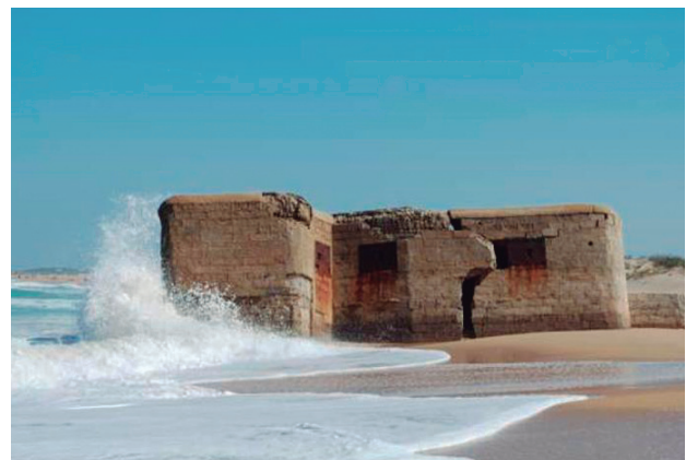
Figuras 10 y 11. Colapso por asiento diferencial excesivo. Playa de Camposoto (San Fernando)
