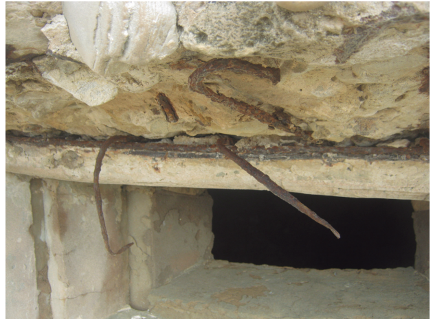
Figura 13. Armadura de muro en avanzado estado de corrosión
